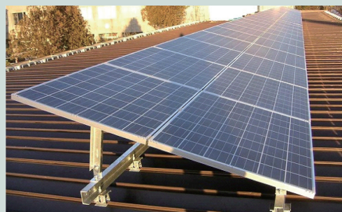
太陽光発電設備
